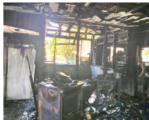
No hubo muertos ni lesionados, solo daños materiales.
