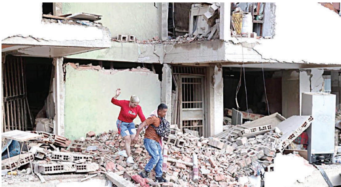
Personas recorren las zonas afectadas por los terremotos en Venezuela mientras continúan las labores de búsqueda y rescate entre los escombros.
