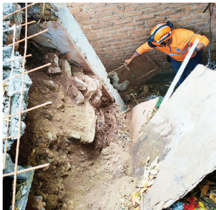
Brigadistas de Copeco atienden a una familia afectada por las lluvias tras daños registrados en su vivienda.
