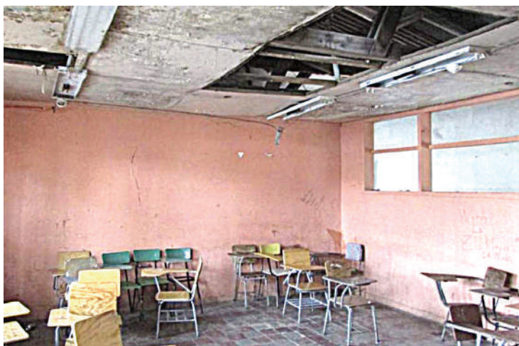
En Honduras 3 de cada días centros escolares están en mal estado.
