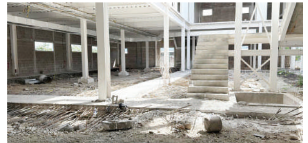
La obra iba a tener varias plantas para dar respuesta a las necesidades de la población.
