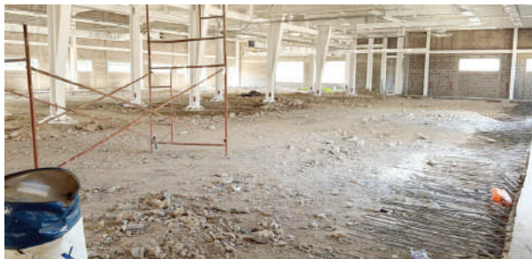
Primera planta sin terminar y en abandono.
