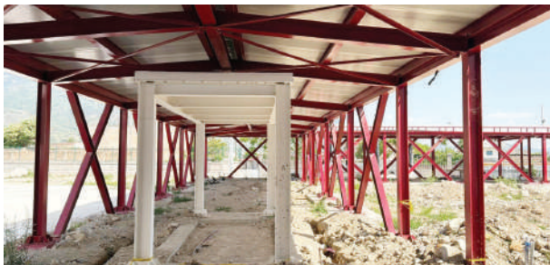
En el terreno se puede observar parte de la obra que quedó inconclusa.
