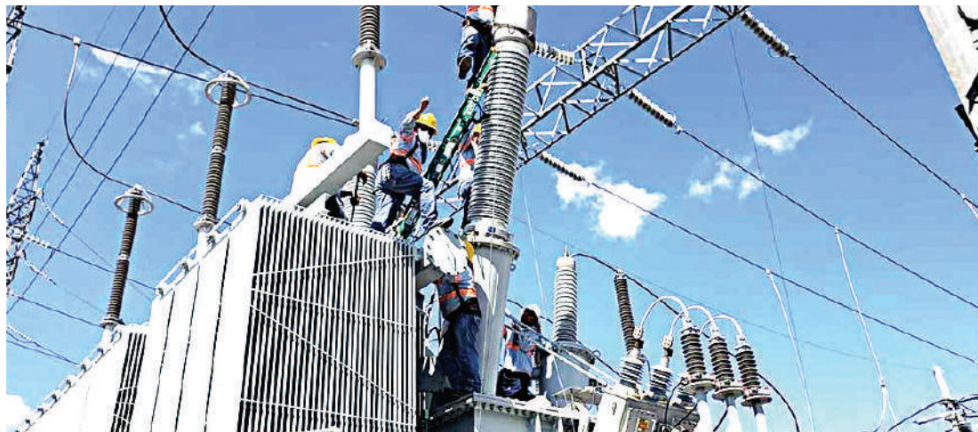
Las pérdidas técnicas y el hurto de energía continúan siendo uno de los principales desafíos financieros y operativos de la ENEE en Honduras.
