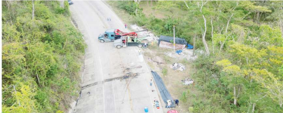
Personal especializado realiza labores de limpieza y contención tras el derrame de cianuro en la CA-4.
