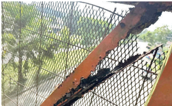
El puente tiene tres décadas de haberse construido. La falta de mantenimiento le ha cobrado factura.
