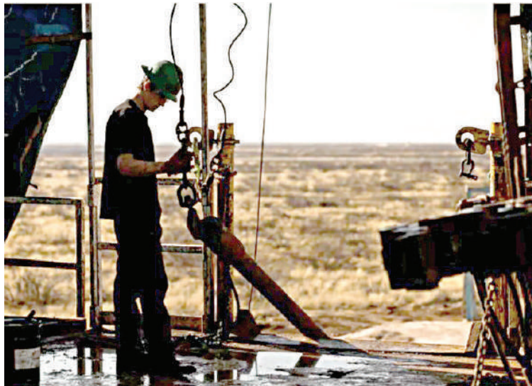
Instalaciones de la industria petrolera en Estados Unidos.
