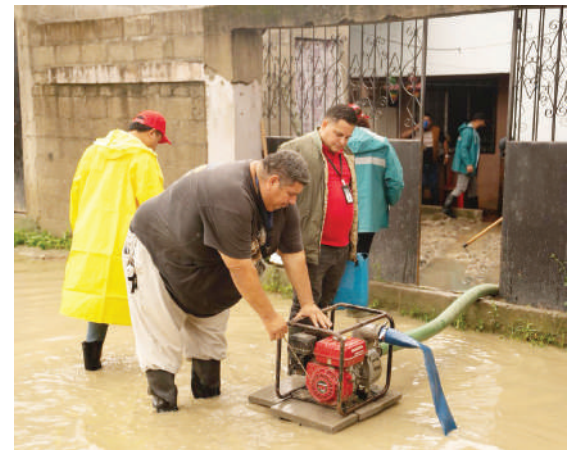
Con bombas achicadoras están atendiendo las viviendas inundadas en diferentes zonas de la ciudad.
