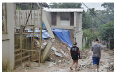
El muro de la iglesia de Dios en la colonia primavera cedió por las lluvias.
