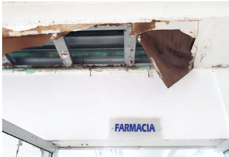
La situación en el hospital no es agradable, ya que está deteriorado.
