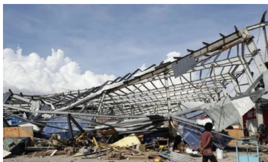
Melissa causó en Jamaica daños catastróficos en viviendas e infraestructura crítica como hospitales y carreteras.
