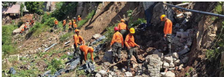
Personal técnico retiran escombros en la colonia La Guillén, como parte de las acciones de limpieza y remoción de material inestable tras los deslizamientos provocados por las lluvias recientes.
