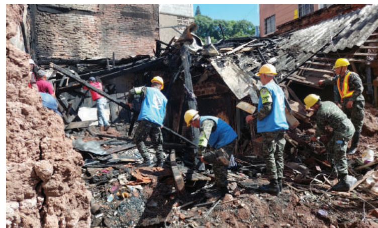
Efectivos de las Fuerzas Armadas inspeccionan viviendas colapsadas en la colonia El Reparto por Bajo.
