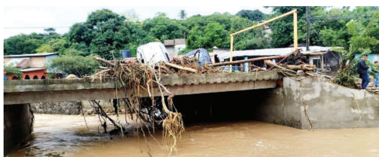
El puente de acceso a Río Abajo, Tegucigalpa, colapsó parcialmente y quedó obstruido por vehículos, árboles y desechos tras el desbordamiento del río.
