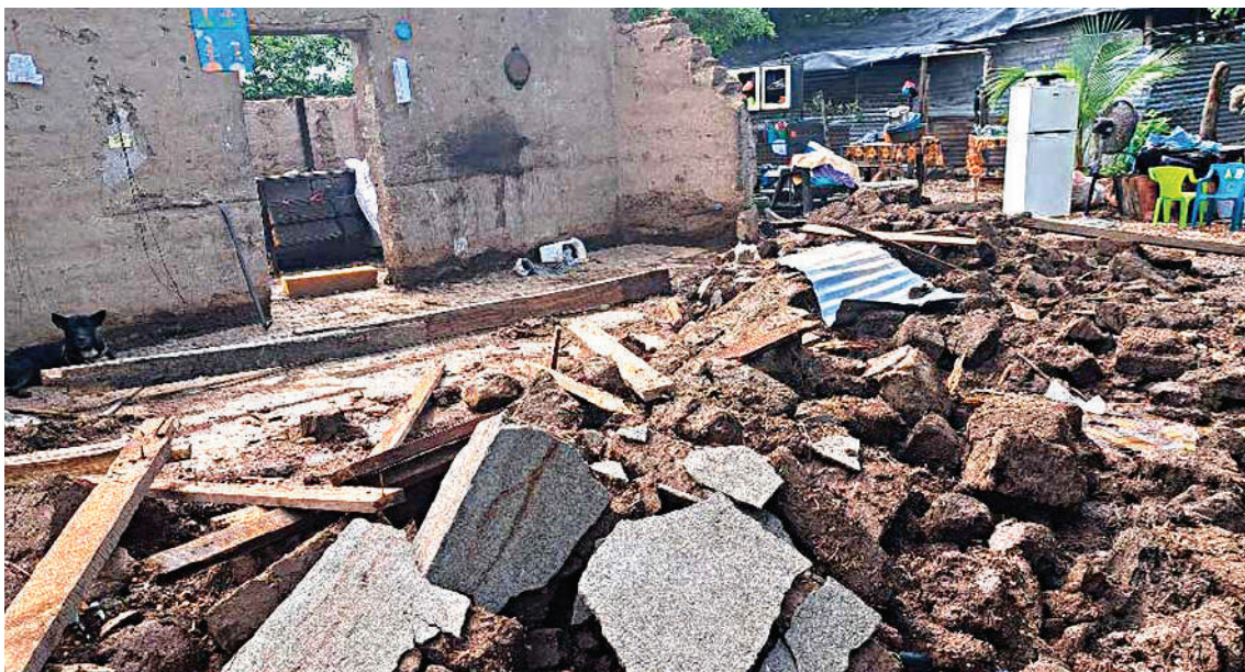
Las lluvias han dejado a familias sin viviendas tras los daños ocasionados.
