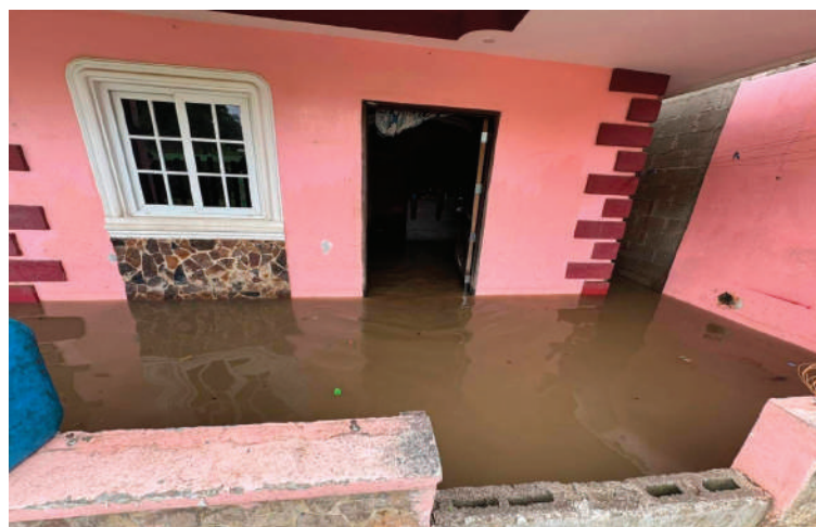
Más de 90 viviendas fueron afectadas en el sector Chamelecón en la zona norte.
