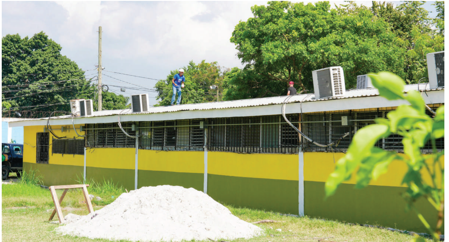
El proyecto del mejoramiento del Centro Básico Brisas del Cacao contempla cambio de techo, cielo falso, sistema eléctrico y pintura.
