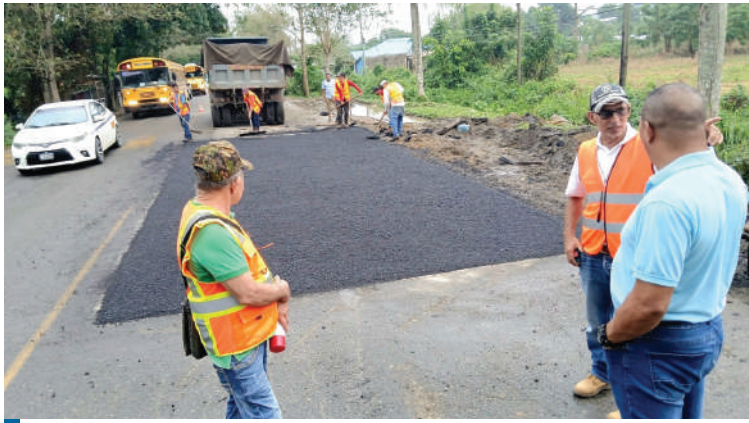
Los tramos más afectados de la CA-13, que une a El Progreso con Tela, están siendo bacheados.
