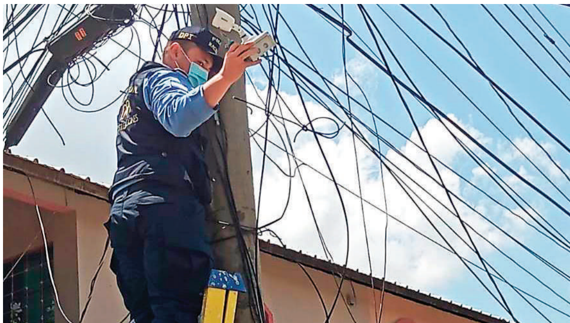
Los agentes se subieron a los postes del tendido eléctrico para desinstalar las cámaras.
