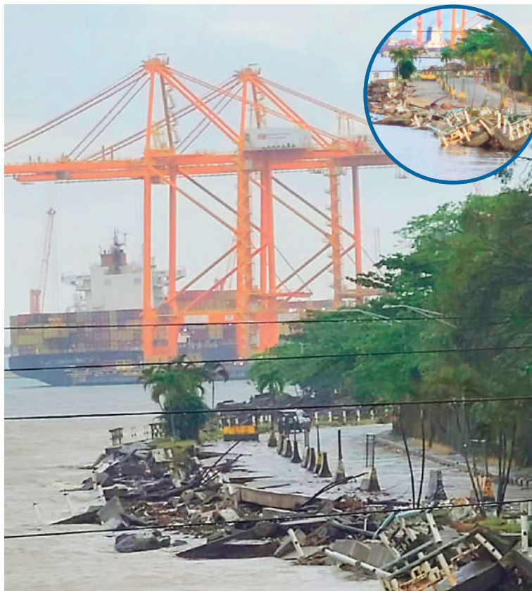
Totalmente destruido ha quedado el malecón.
