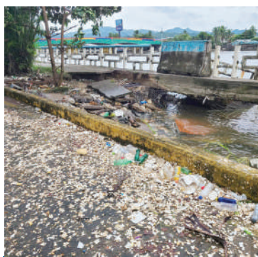
Totalmente destruido ha quedado el malecón.
