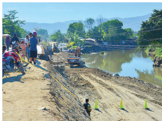
Los bordos requieren de mejoras para evitar las inundaciones en varias colonias de la ciudad.
