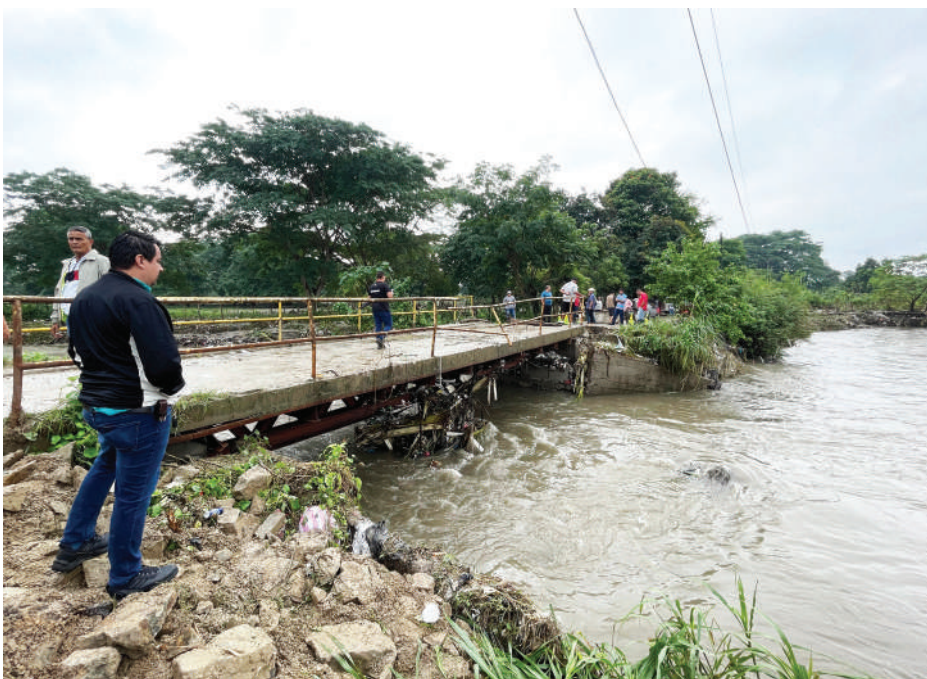
En la colonia Larios Silva de San Pedro Sula los habitantes están preocupados porque el puente está a punto de colapsar.
