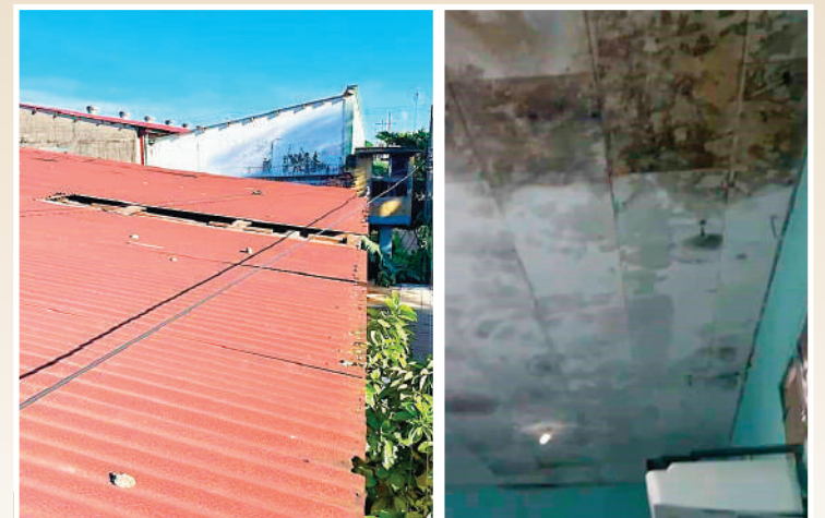
Filtraciones de agua lluvia debido a lo deteriorado del zinc, tienen intranquilos a los policías porteños
