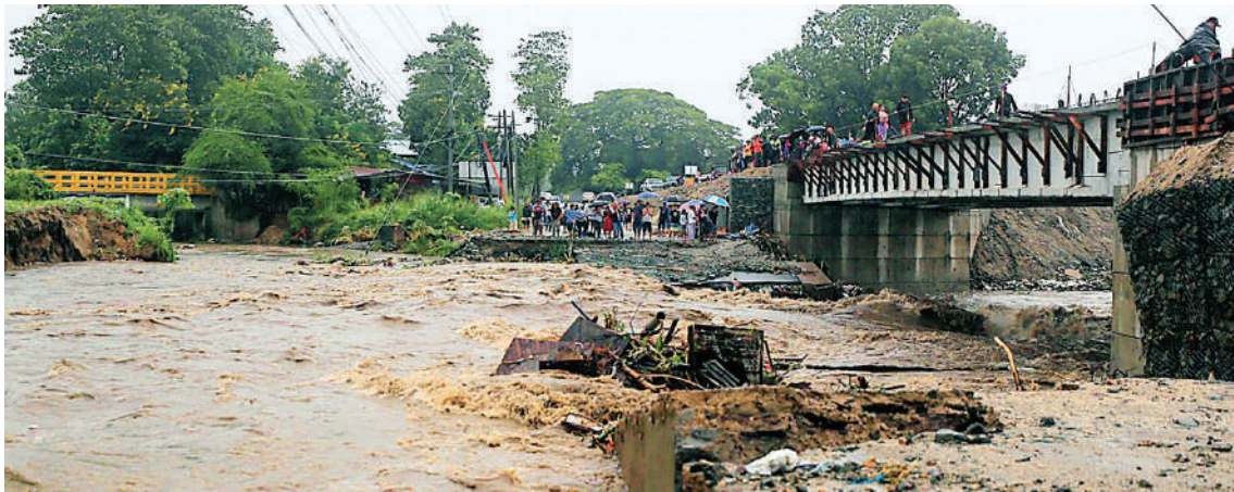
La tormenta Sara dejó decenas de puentes dañados y varios sectores incomunicados.
