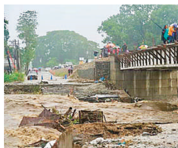
El fenómeno natural dejó múltiples puentes destruidos.
