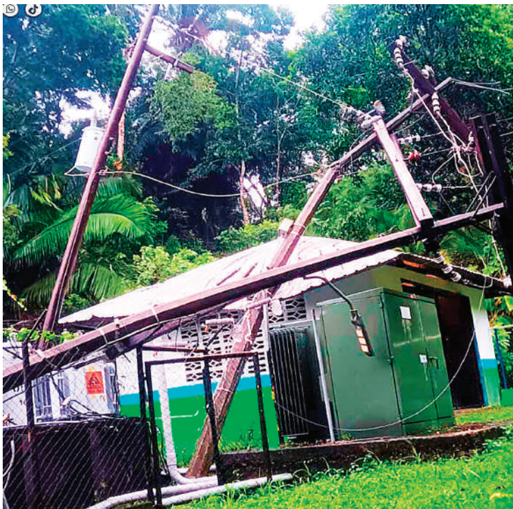
Postes del tendido eléctrico cayeron sobre las casas.
