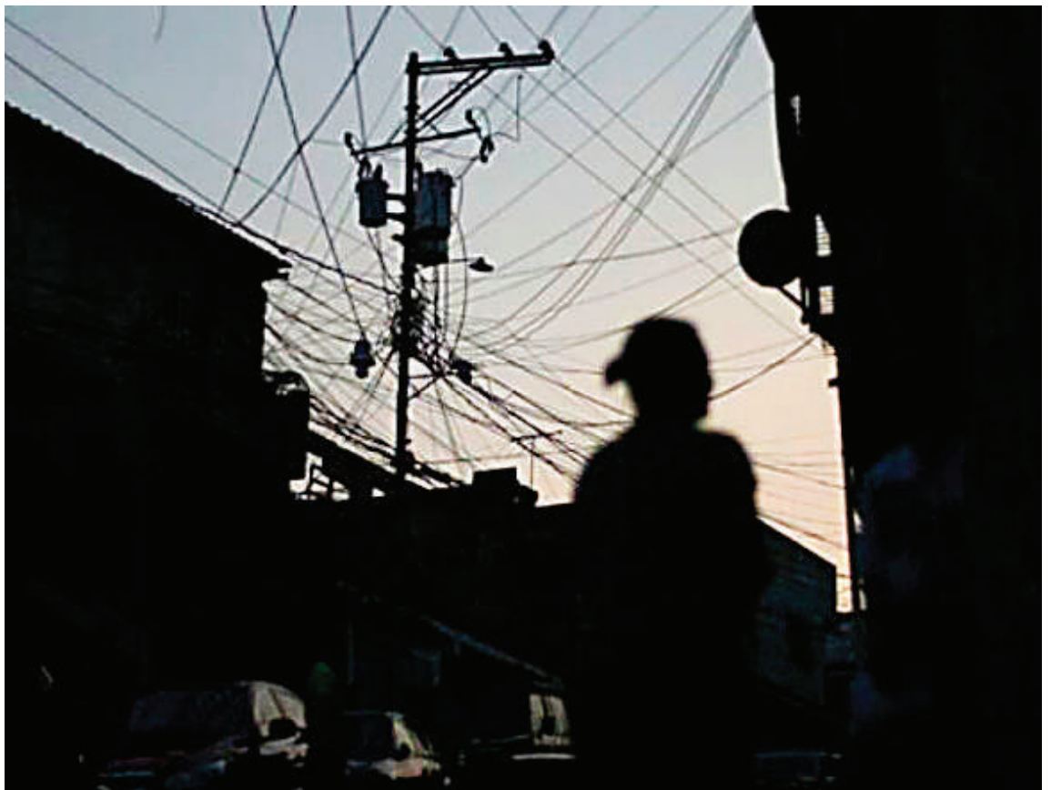
Los ciudadanos sufrieron por falta de energía eléctrica en varias partes del país.
