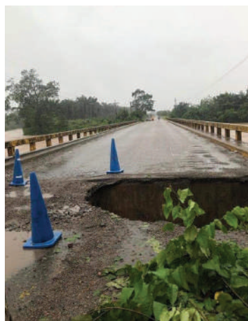
El puente sobre la carretera CA-13 por la aldea Perú, también se dañó debido a las lluvias.
