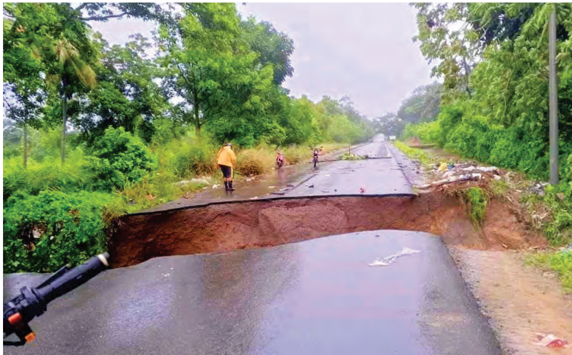
Entre Sabá y Olanchito este puente colapsó y ha dejado incomunicada a los habitantes.
