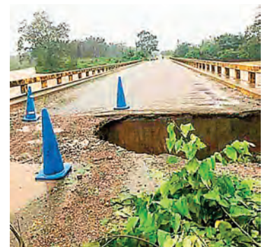
El puente ubicado en el sector de La Ulera San Alejo en Tela, la tarde de ayer estaba a punto de colapsar.
