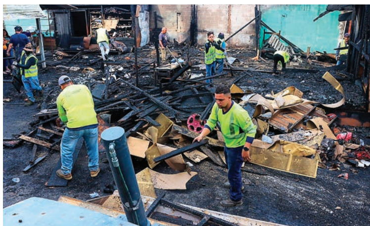
Las cuadrillas de la alcaldía sampedrana llegaron a retirar los escombros.
