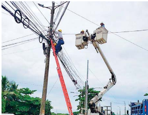
El servicio de iluminación pública está colapsado hace meses.
