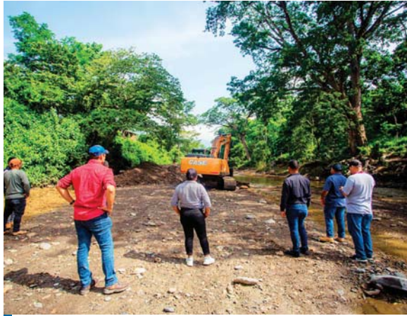
Con la obra sobre el cauce del río Manchaguala se mitigarán los problemas de inundación en la zona durante la temporada lluviosa.
