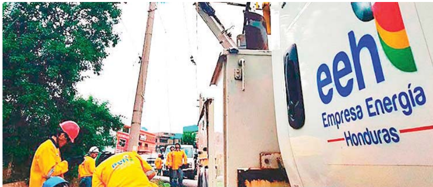
La EEH dejó de instalar más de 400 mil medidores y las pérdidas técnicas y no técnicas quedan por arriba del 31 por ciento, asegura la estatal ENEE.
