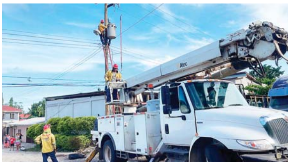
Los pobladores confían que este tipo de problemas con transformadores colapsados no sigan pasando.
