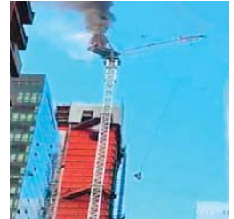
El incendio de la grúa dañó otros edificios que estaban cerca.
