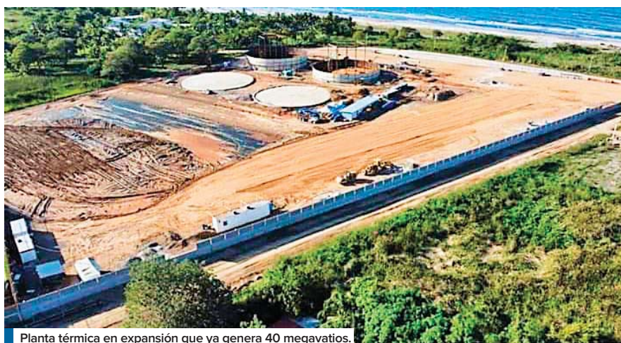
Planta térmica en expansión que ya genera 40 megavatios.
