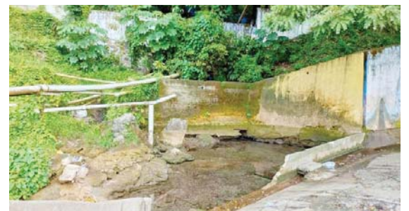
La poza quedó destruida por las continuas tomas que realizan los camiones con sus mangueras.
