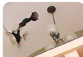
La casa de la familia Paz Laínez sufrió daños en el techo debido a las ramas del árbol.
