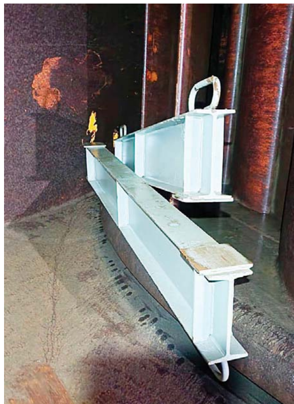
Fotos de las vigas encontradas en el túnel de la unidad número dos de la represa Patuca III, publicadas por el secretario de Energía (SEN) y gerente interino de la ENEE.
