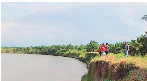
Se repararán los bordos de contención en Remolino y la Cacariquera, anunció el Gobierno.
