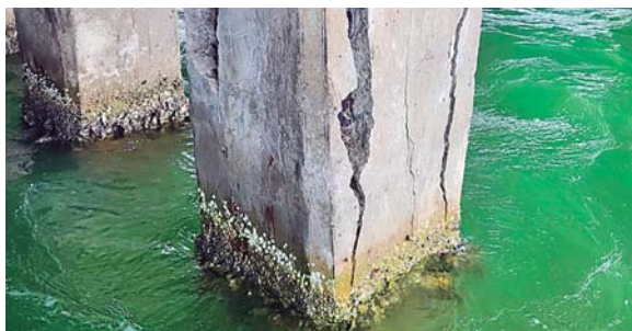
Por encima los puentes solo se reflejan leves averías, pero las bases están bien deterioradas.
