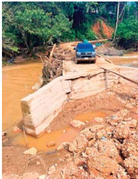
Muchos puentes colapsaron con la presencia de los fuertes aguaceros en Olancho.
