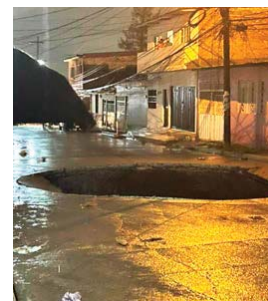
Las fuertes lluvias dañaron una de las calles de la residencial.
