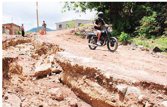
En Altos de la Sosa se ha vuelto una zona de alto riesgo.
