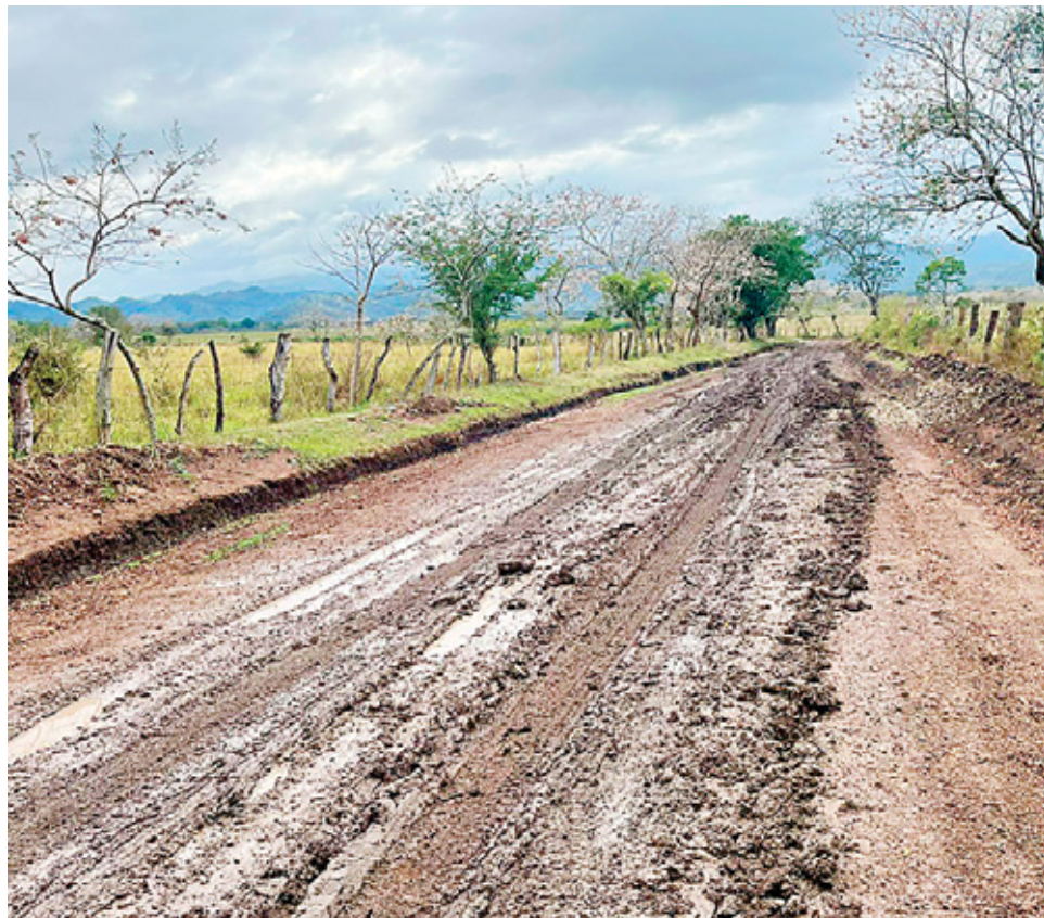
Cada vez que llueve se forma una capa de lodo que dificulta el paso de los vehículos.
