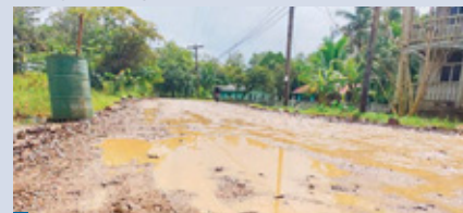
La calle presenta severos daños, los que se han incrementado con las lluvias de los últimos días.
