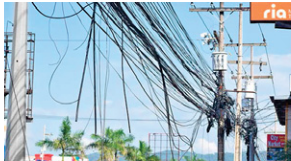
Incluso algunos de los cables están cortados, bajo el riesgo de que alguien sufra un percance.
