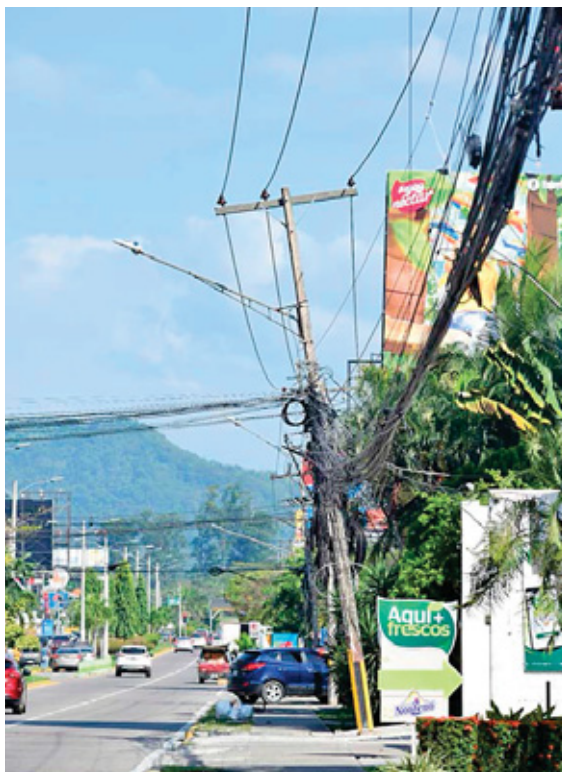
Muchos cables ya no tienen un servicio práctico.
