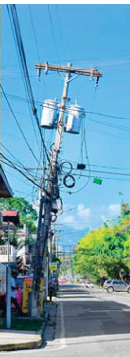
También los postes han sufrido daño.
