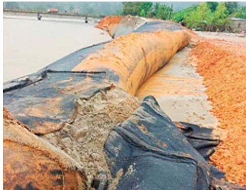
La borda ubicada en el río Tegucigalpa, en Omoa, cedió ayer producto de las fuertes lluvias.
