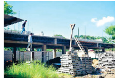
La escuela Fesitranh, en la Céleo Gonzales, sigue en reconstrucción; tuvo que ser demolida ante el mal estado en el que quedó.
