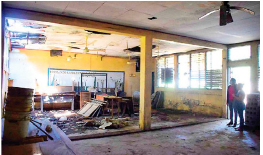
En el centro Carlos Alberto Rivera de la RH, la mayoría de aulas tienen los techos destruidos. No hay ni energía eléctrica.
