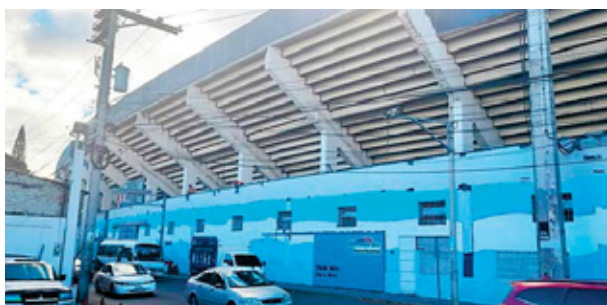
Sol Este tiene algunas vigas debilitadas por el paso del tiempo y diferentes agentes contaminantes.
