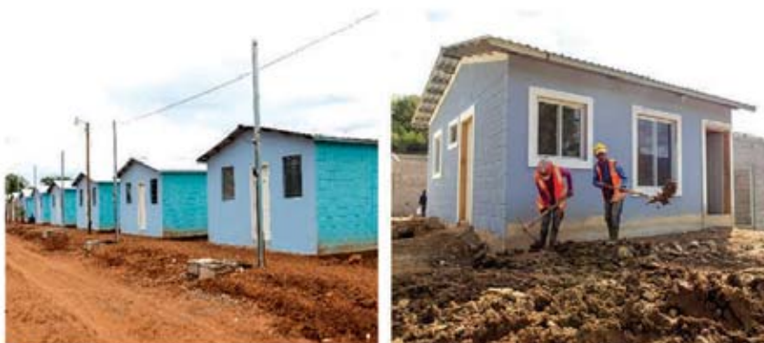
La construcción de viviendas avanza en Olanchito, Yoro y Macuelizo, Santa Bárbara
