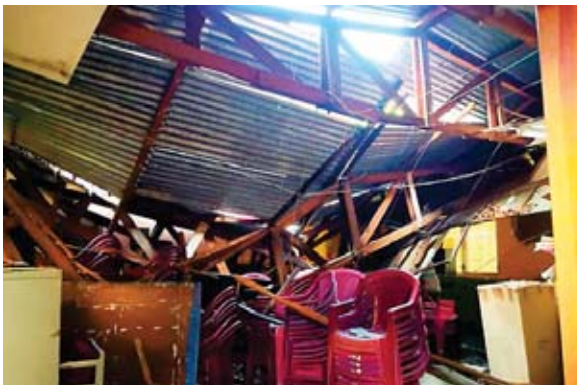
El techo de las aulas colapsó, las mesas, sillas y demás muebles que tenían se dañaron, el lugar quedó destruido.
