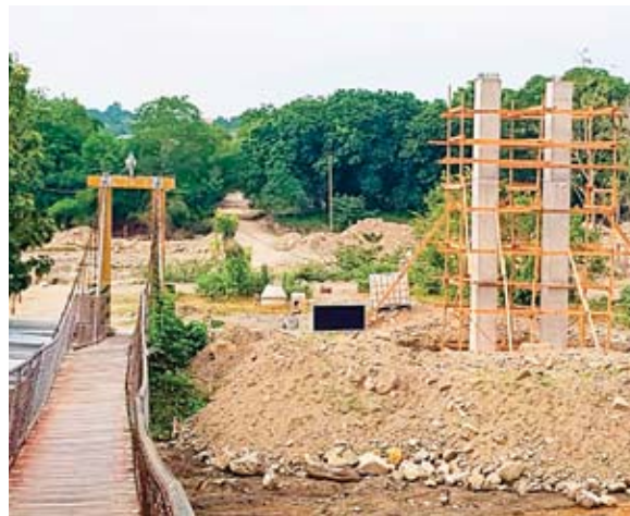
La obra ya avanzó en la parte más difícil, que es la fundición.
